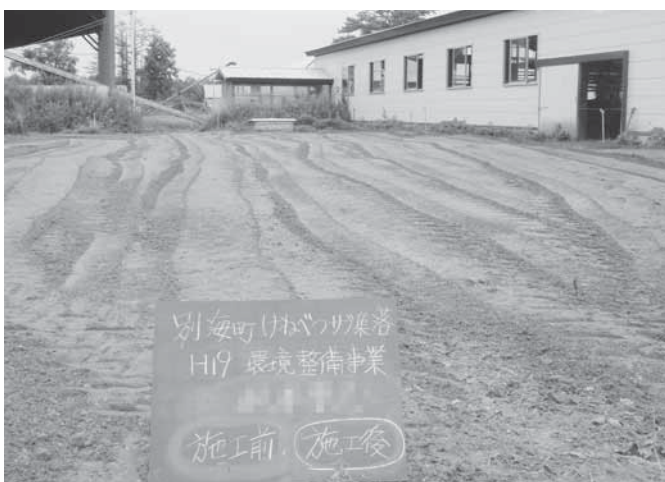
施工後：火山礫が敷かれ、景観や衛生的にも整備されました
